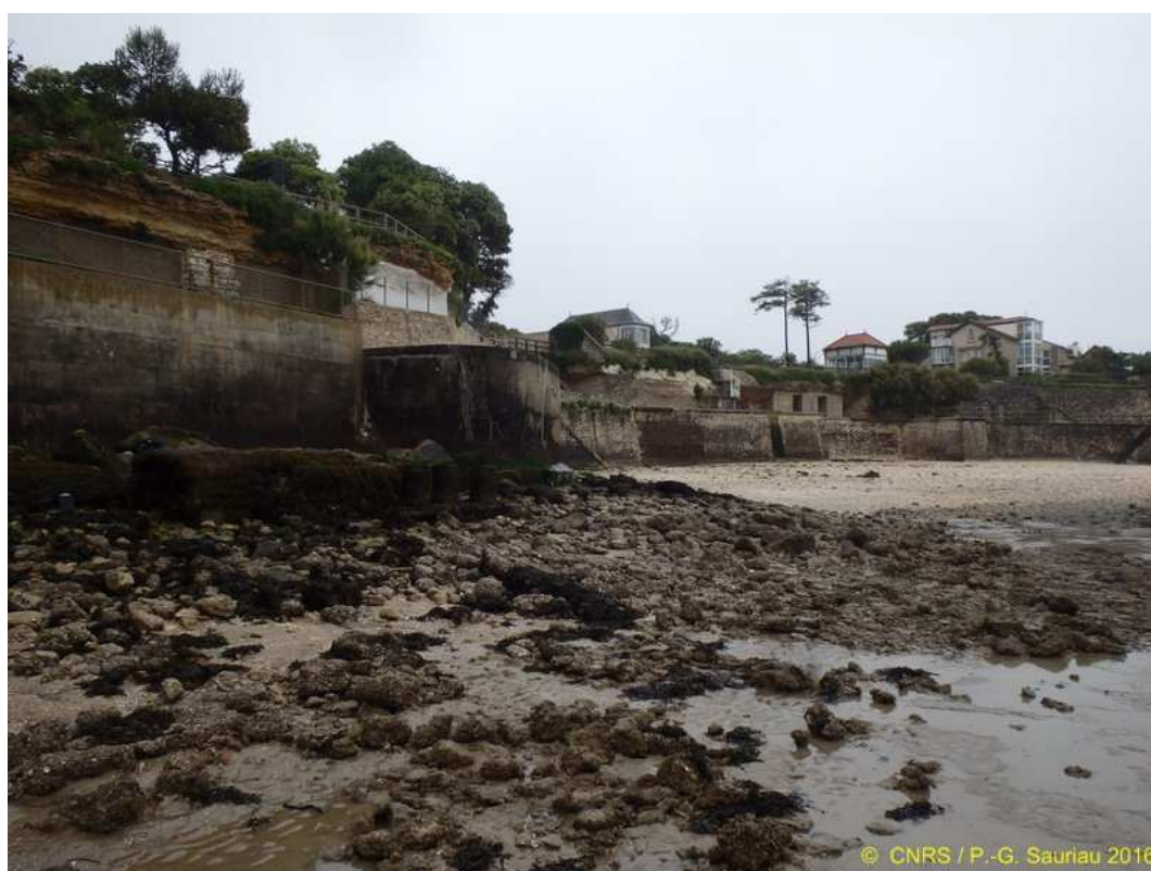
Fig. 34 : Vue générale de la station « Fouras Casino (Charente) IR » en bas de falaise
